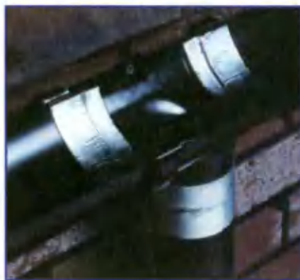
Трещины в водосточных желобах и трубах герметизируют алюминиевой лентой (Фольгоизолом).
